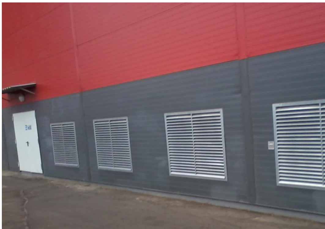
30 pav. Biokuro katilinės ventiliacinės sistemos
