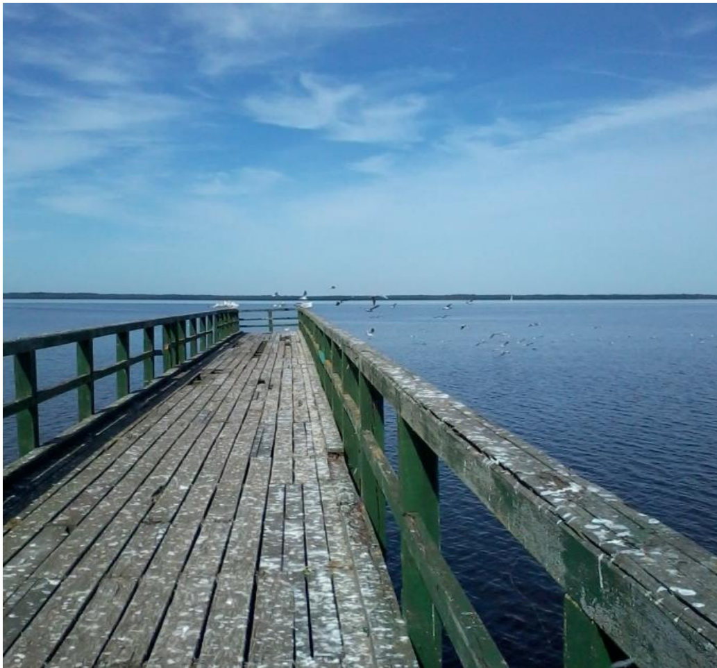
25 pav. Avarinės būklės Rėkyvos ežero tiltas
