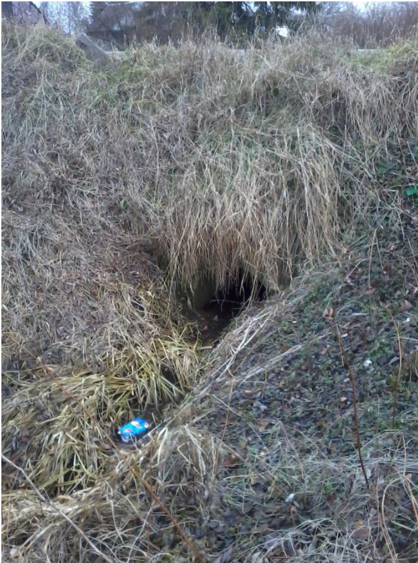
30 pav. Paviršinių nuotekų išleistuvas Nr.34 (Bačiūnų g. griovyje).
