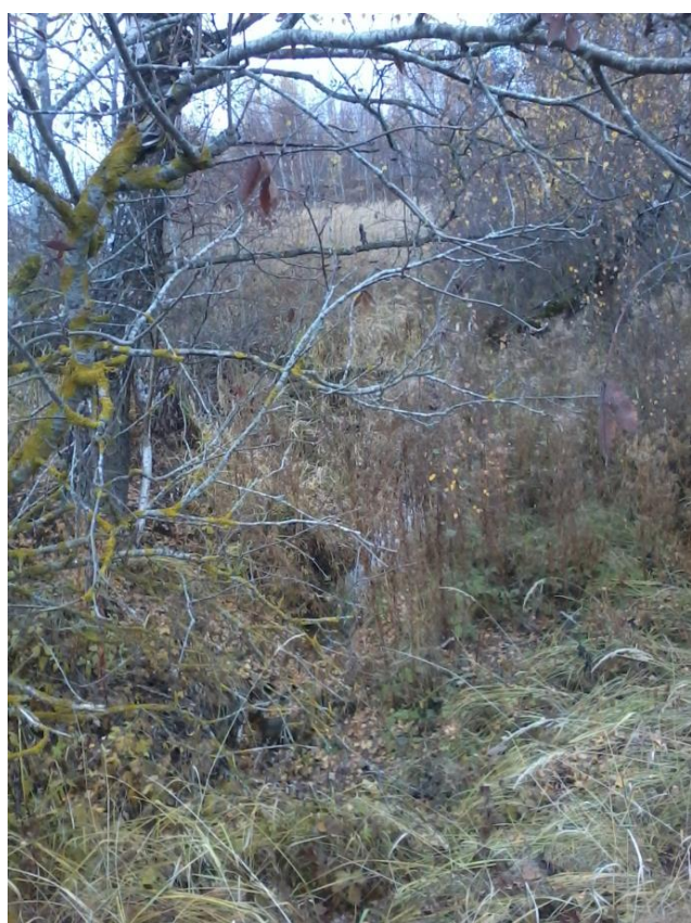
28 pav. Paviršinių nuotekų išleistuvas Nr.32 (Bačiūnų g. griovyje)
